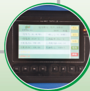
控制面板 Control panel
